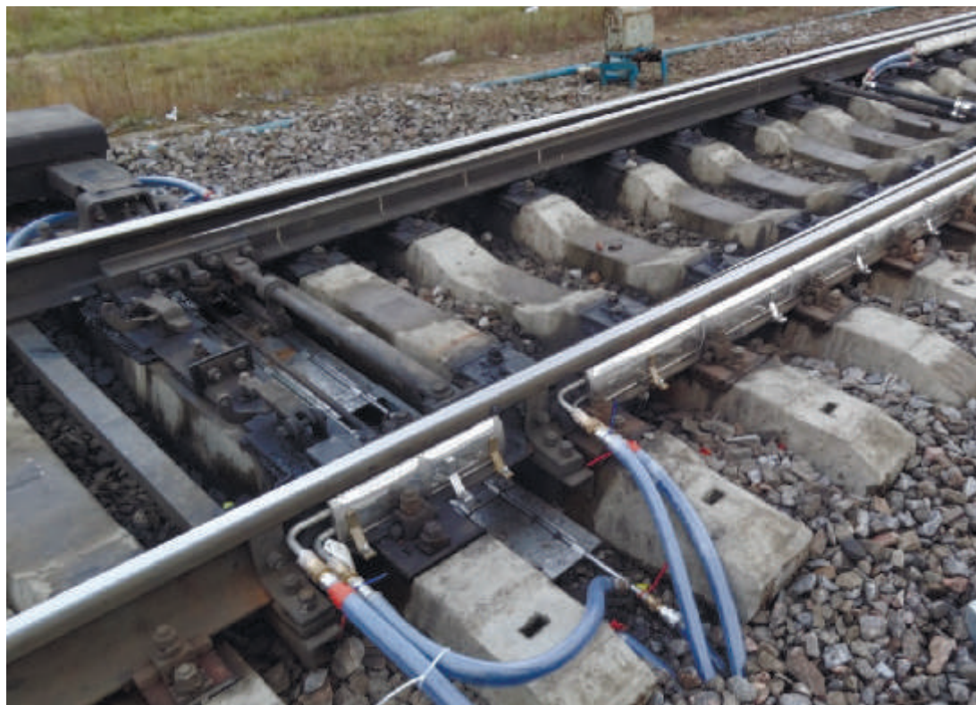
Рис. 27. Система геотермического обогрева стрелочного перевода
