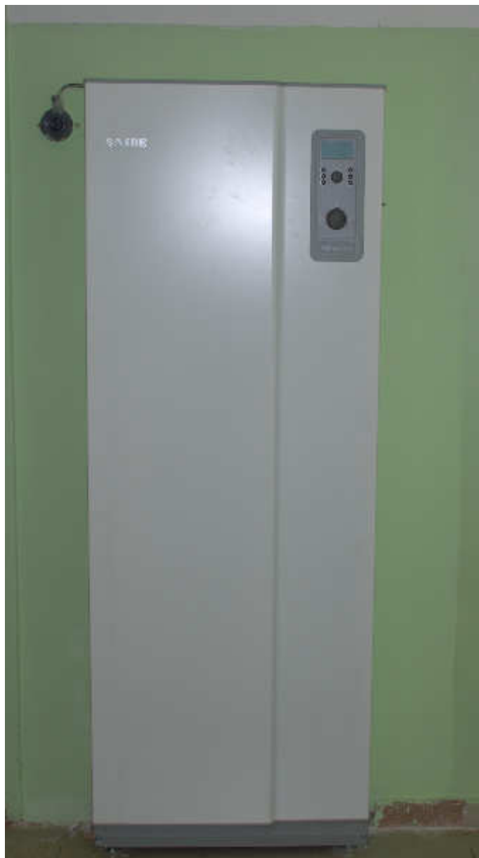
Рис. 22. Тепловой насос, работающий на сточных водах
