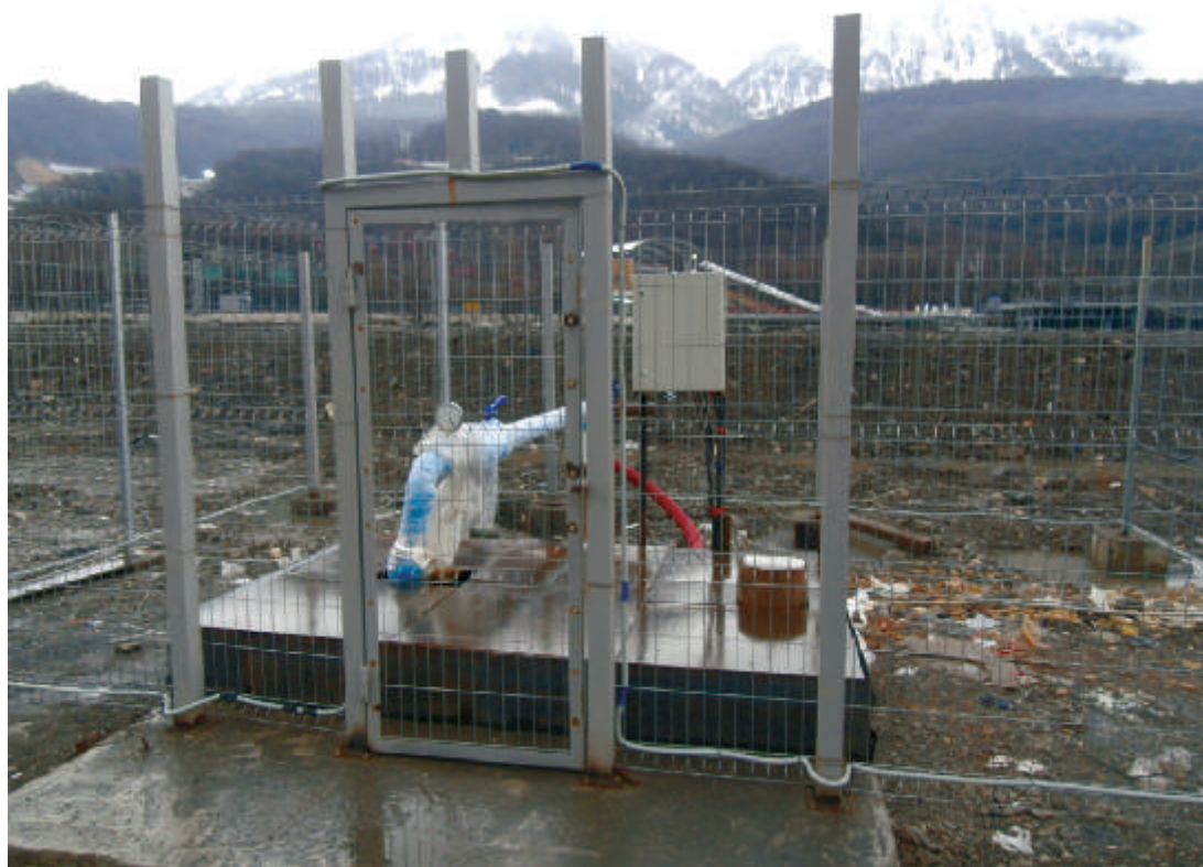
Рис. 25. Фото скважины ТНУ
